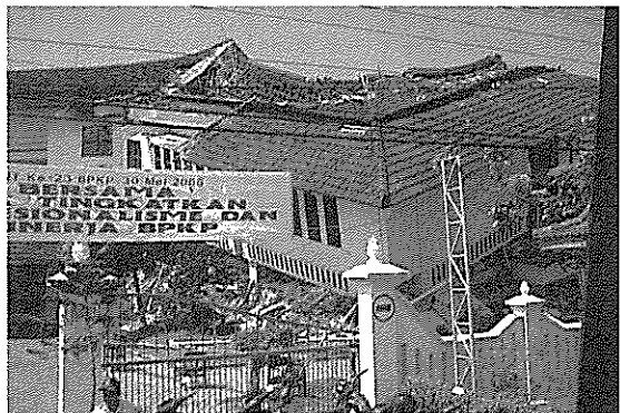
ジョグジャカルタ市内の被災建物
